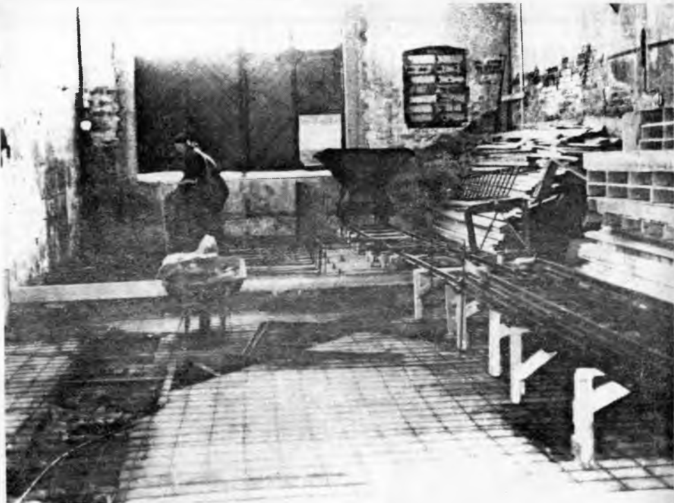
En dålig bild inifrån lokstallet i Svartvik. Monteringen av armeringen pågår. Trallspåret till höger skall användas för utkörning av betongen vid gjutningen av bottenplattan. Vi är ju järnvägsintresserade, eller hur?
